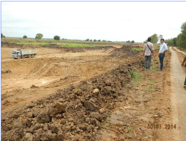
ขุดลอกสระเก็บน้ำบ้านวังกร่าง ม.๑๒ เนินมะกอก อ.บางมูลนาก จ.พิจิตร
